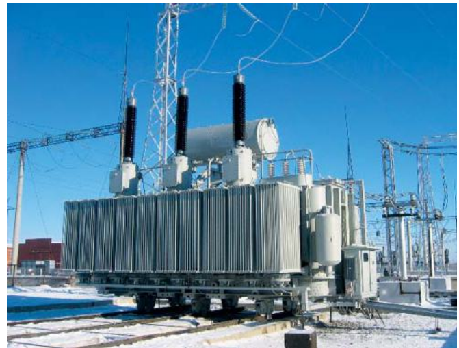
Рис. 1. УШР на базе РТУ-100000/220 на ПС «Хабаровск»
