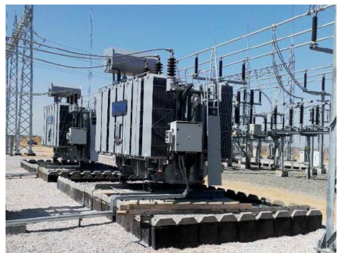
Рис. 2. УШР на базе РТУ-10000/10 на ПС «Кумколь» (Республика Казахстан)
